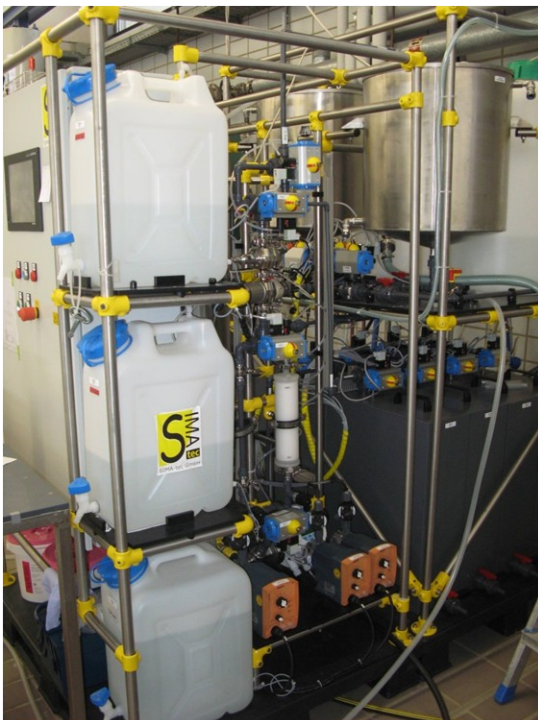
Bild 1: Pilot-Chromatographieanlage mit einer Mitsubishi Melsec-Steuerung
